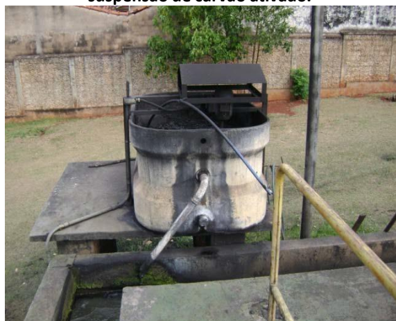
Figura 5.25: Sistema de preparo e dosagem de suspensão de carvão ativado.
