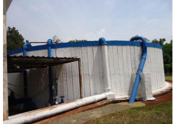
Figura 5.77: Centro de reservação ETA III – Reservatório RP2.
