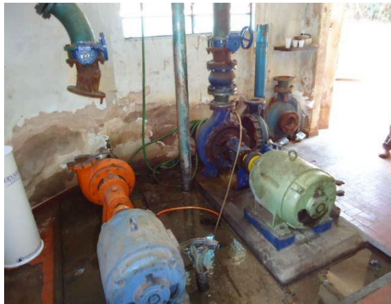
Figura 5.95: Detalhe das Bombas da estação elevatória Fórum.
