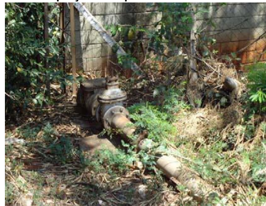
Figura 5.51: RP1 – Detalhe da bomba do poço de captação do Aquífero Serra Geral.
