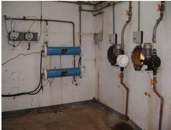
Figura 5.22: Sistema de geração e dosagem de hipoclorito de sódio.
