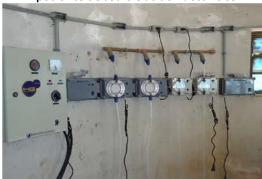
Figura 5.52: RP1 – Detalhe das bombas dosadoras de hipoclorito de sódio e ácido fluossilícico.
