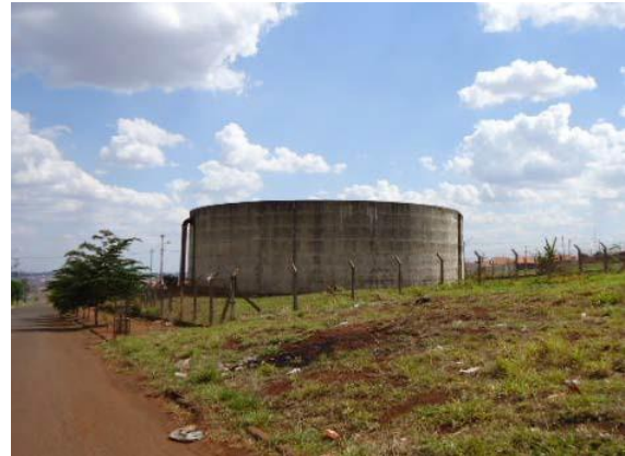
Figura 5.83: Centro de reservação Jd. Novo Horizonte - Reservatório R15.
