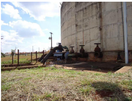
Figura 5.98: Bomba (sem reserva) do sistema de recalque Jd. Novo Horizonte.
