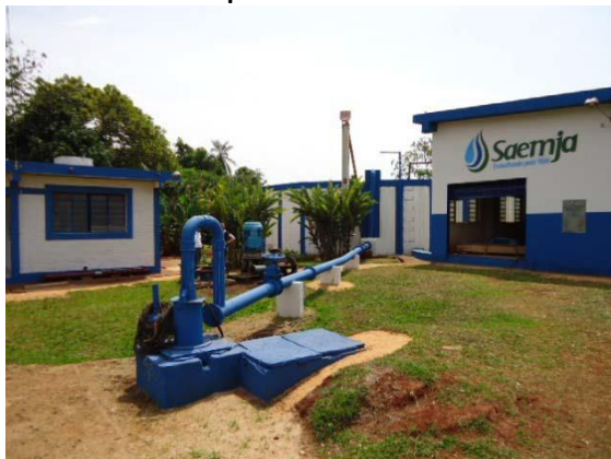
Figura 5.50: RP2 – Vista do poço de captação do Aquífero Guarani.
