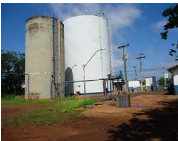
Figura 10.5 - Poço profundo e reservatórios.
