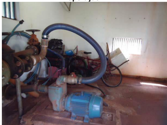
Figura 5.28: Sistema de recalque. Única bomba em operação.
