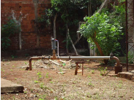
Figura 5.54: Detalhe Poço de captação P5 e do sistema de cloração.
