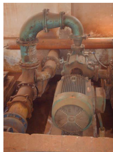
Figura 5.97: Detalhe de um dos conjuntos de bombas da estação elevatória ETA III.
