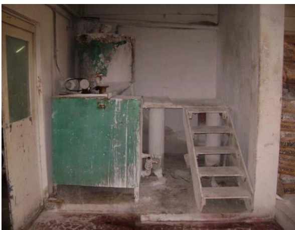
Figura 5.24: Tanque de preparo da suspensão de cal.
