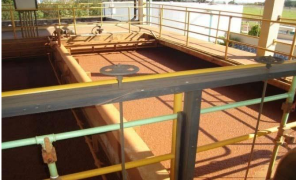
Figura 5.41: ETA II - Vista geral da câmara de flotação, observação do manto de lodo flotado em sua superfície.
