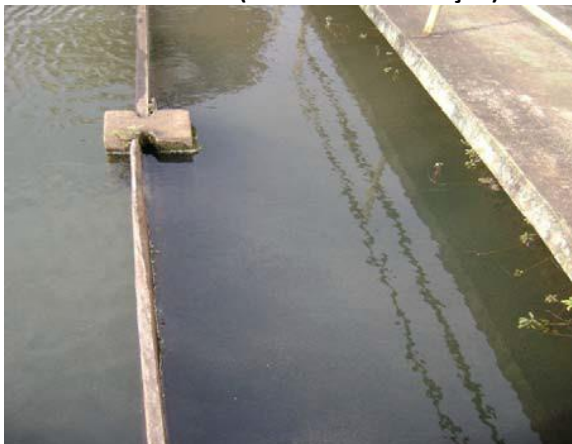
Figura 5.14: Entrada de água floculada nos decantadores (cortina de distribuição).
