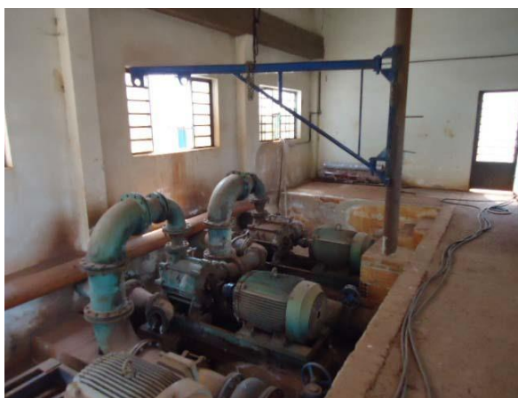
Figura 5.96: Vista das instalações da estação elevatória ETA III.
