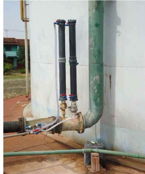
Figura 5.49: RP8 - Sistema de cloração com pastilhas de cloro na entrada do reservatório.
