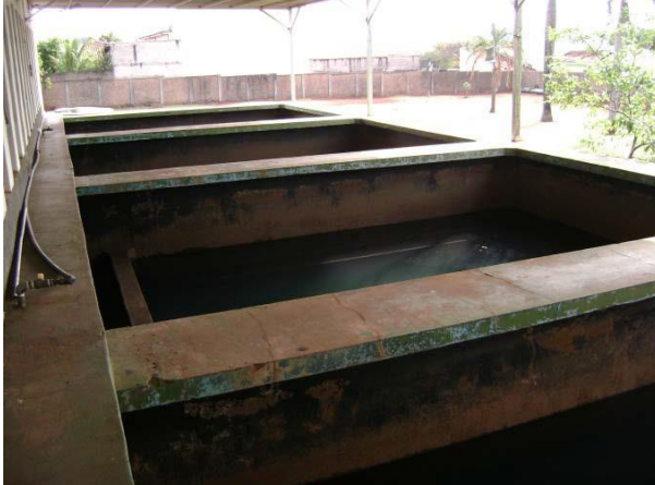
Figura 5.16: Vista dos quatro filtros existentes.
