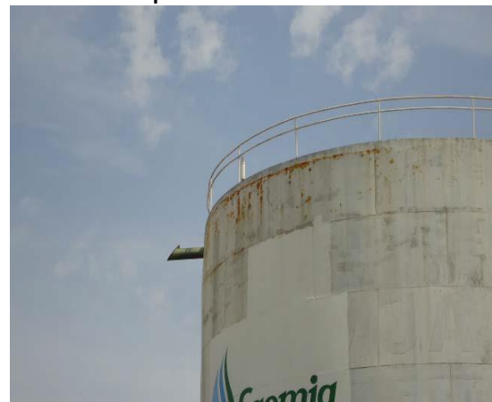
Figura 5.70: R12 – Detalhe da corrosão na parte superior do reservatório.
