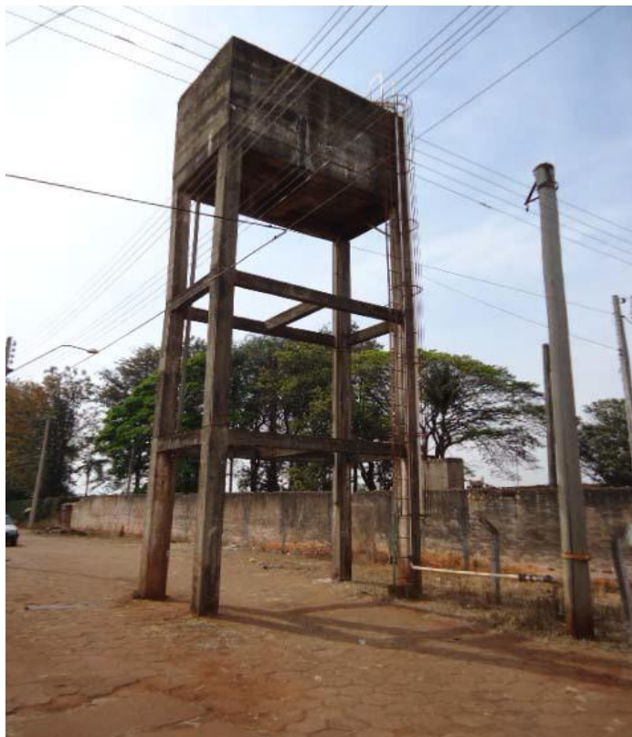
Figura 10.20 - Poço e Reservatório Elevado do Distrito Concha de Ouro.
