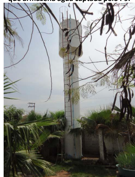
Figura 5.59: Reservatório do Balneário Aristides Coló, que armazena água captada pelo P9.
