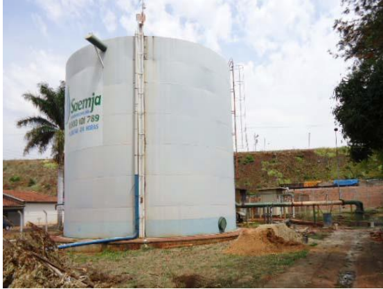
Figura 5.65: Centro de reservação Santo Antônio – RP4.
