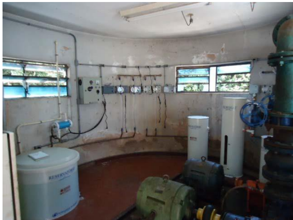
Figura 5.94: Vista das instalações da estação elevatória Fórum.
