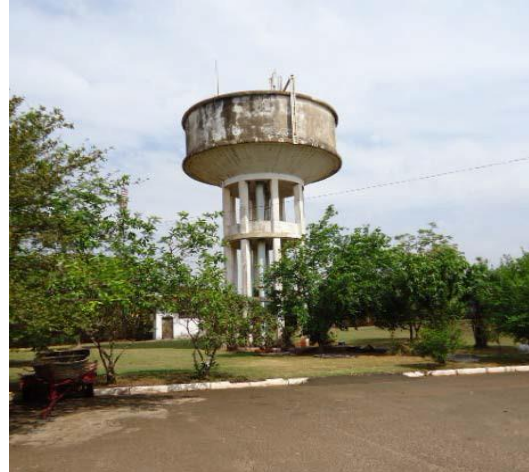
Figura 5.61: Centro de reservação ETA I - Reservatório T1.
