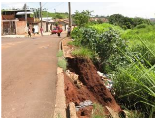
Foto 10 – Desabamento na Rua Paulo Ronchezel
