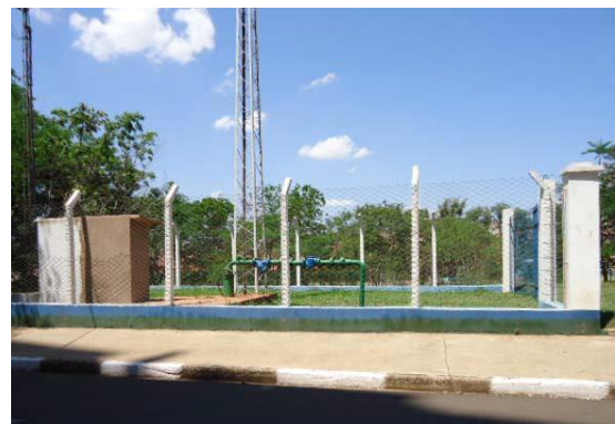
Figura 5.53: Poço de captação P3
