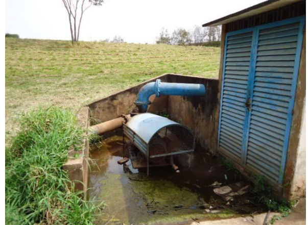
Figura 5.11: Sistema de recalque na Represa São Joaquim. Única bomba instalada ao tempo.
