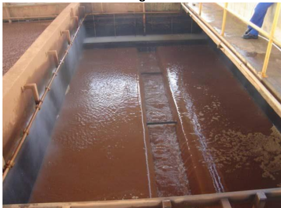
Figura 5.43: ETA II - Lavagem do filtro com água, destaque para calha de coleta de efluente da lavagem.
