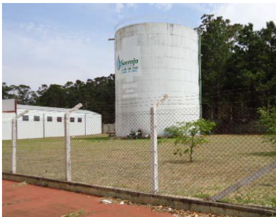
Figura 5.69: Centro de reservação Distrito Industrial – R12.
