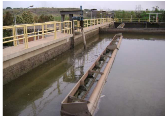
Figura 6.6: Vista dos tanques de aeração/decação, com destaque para os vertedores flutuantes de coleta do sobrenadante (efluente tratado).
